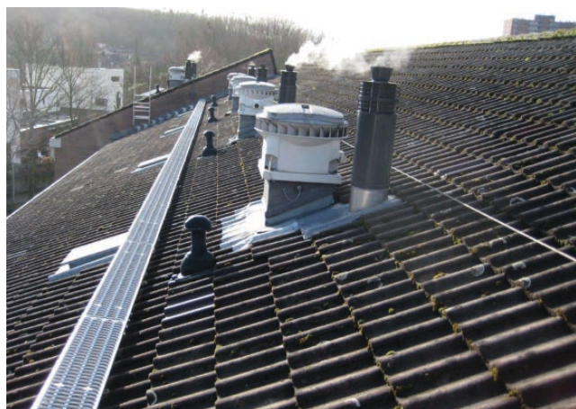
Foto 2a: kabelsysteem op schuin dak
