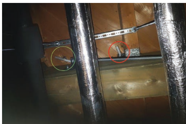
Foto 4b: constructiebalk verhindert uitvouwen kantelbouten
