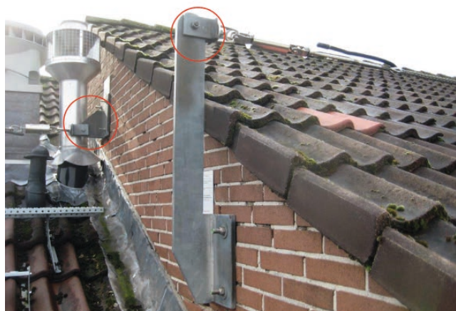
Foto 2b: gebruik van verboden klemverbindingen
